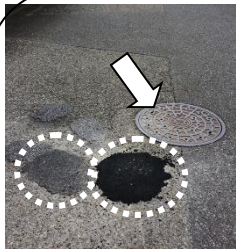
マンホール(矢印)手前、右の点線内が穴(補修済み)。同じく左は以前補修した箇所。
