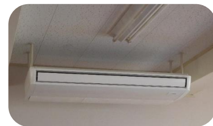
教室に設置されたエアコン
