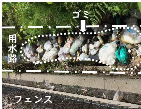
フェンス越しに用水路を上から撮影。ゴミ（点線内）が散乱していた。
