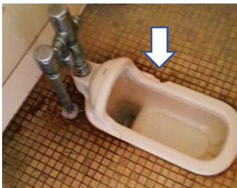
和式便器のフチが欠けていた(⇒下の部分)。
