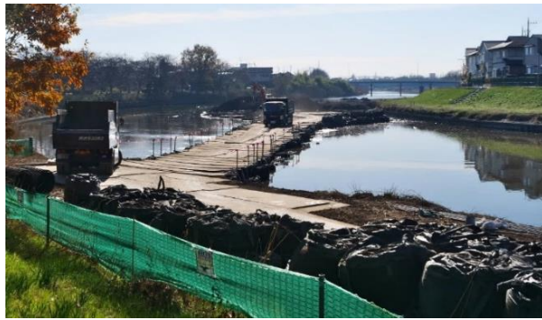
椿山2丁目の河川敷より→方向に撮影した新今宮橋～新荒川橋間の浚渫工事の様子
