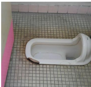
トイレの破損や臭いがひどかった。 【2020年11月 黒浜北小にて撮影】
